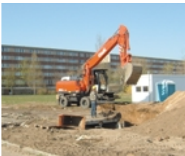
Entnahme der Kollektoren aus dem Straßenkörper: das Straßenraster bleibt für zukünftige Waldwege erhalten
