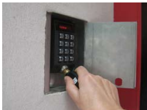
Über ein Codierungsgerät am Eingang der Gemeinschaftseinrichtung werden die entsprechend der via Internet vorgenommenen Buchung befristeten Zugangsberechtigungen für bestimmte Räume auf den Schlüsseln geladen (Düsseldorf)
